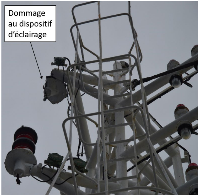
Figure 2. Dommages au mât des feux (Source : BST)
