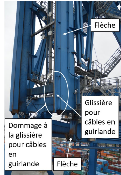
Figure 3. Dommages au portique (Source : BST)
