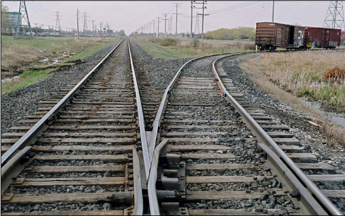
Photo 1. Branchement WC20 au point milliaire 1,8
