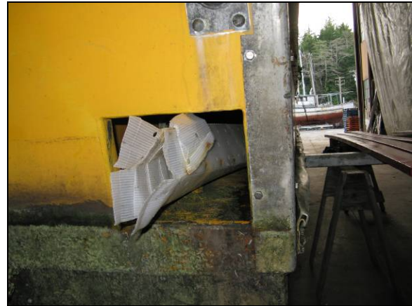
Photo 4. Cône dépassant du sabord de décharge tribord
