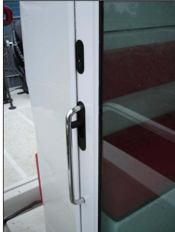
Photo 3. Vue vers l'arrière de la poignée et du loquet de la porte tribord (installée à l'envers)
